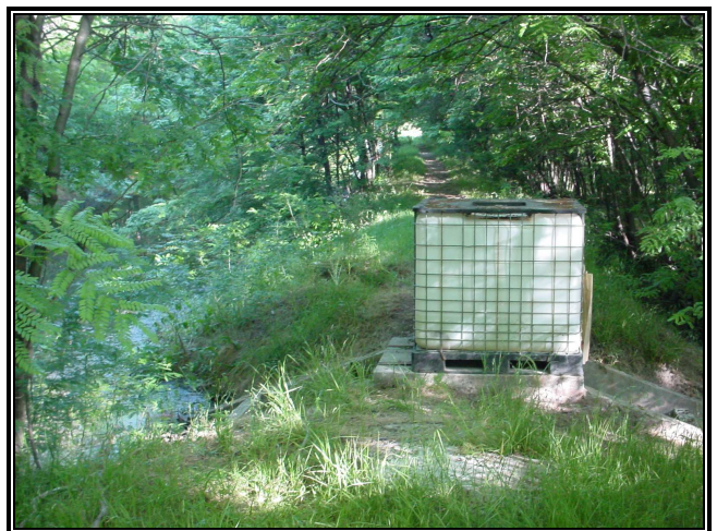
Foto 17. Clorificador de la curtiembre TANERCO
