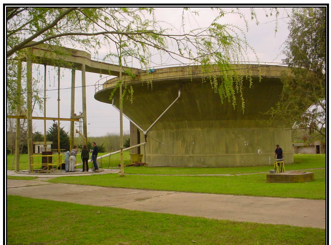
Foto 23. Planta municipal de tratamiento de residuos cloacales
