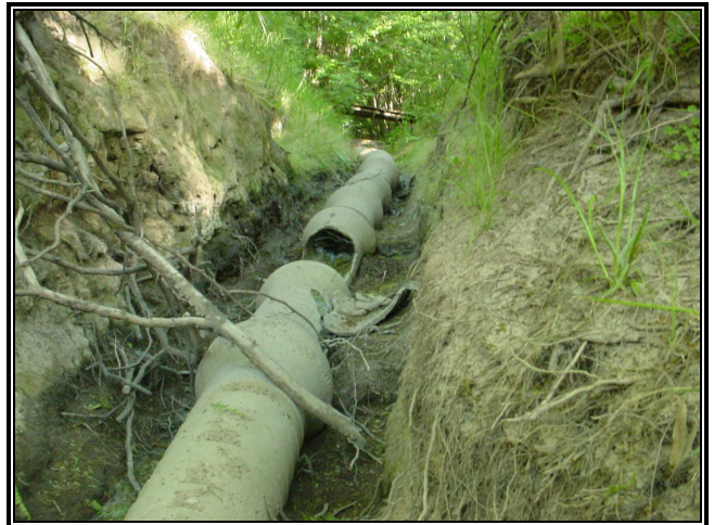
Foto 16. Caño de desagüe al río de la curtiembre TANERCO
