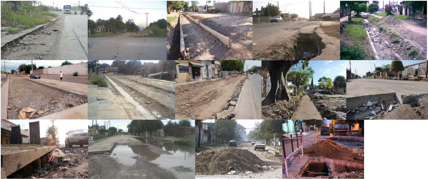
Calles inconclusas, en algunos casos figuran como inauguradas, con presupuesto asignado y formalmente ejecutado.
