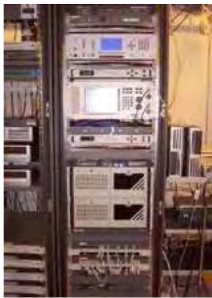
Figura J.3: Rack con equipos para encoder y MUX previa a la subida satelital.
