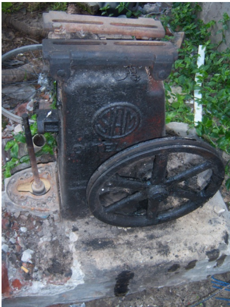
Barrio: Las Acacias, perforación con “bombedador” de 30 metros de profundidad y 25 años de antigüedad. En desuso por la presencia de aceite desde 2008.
