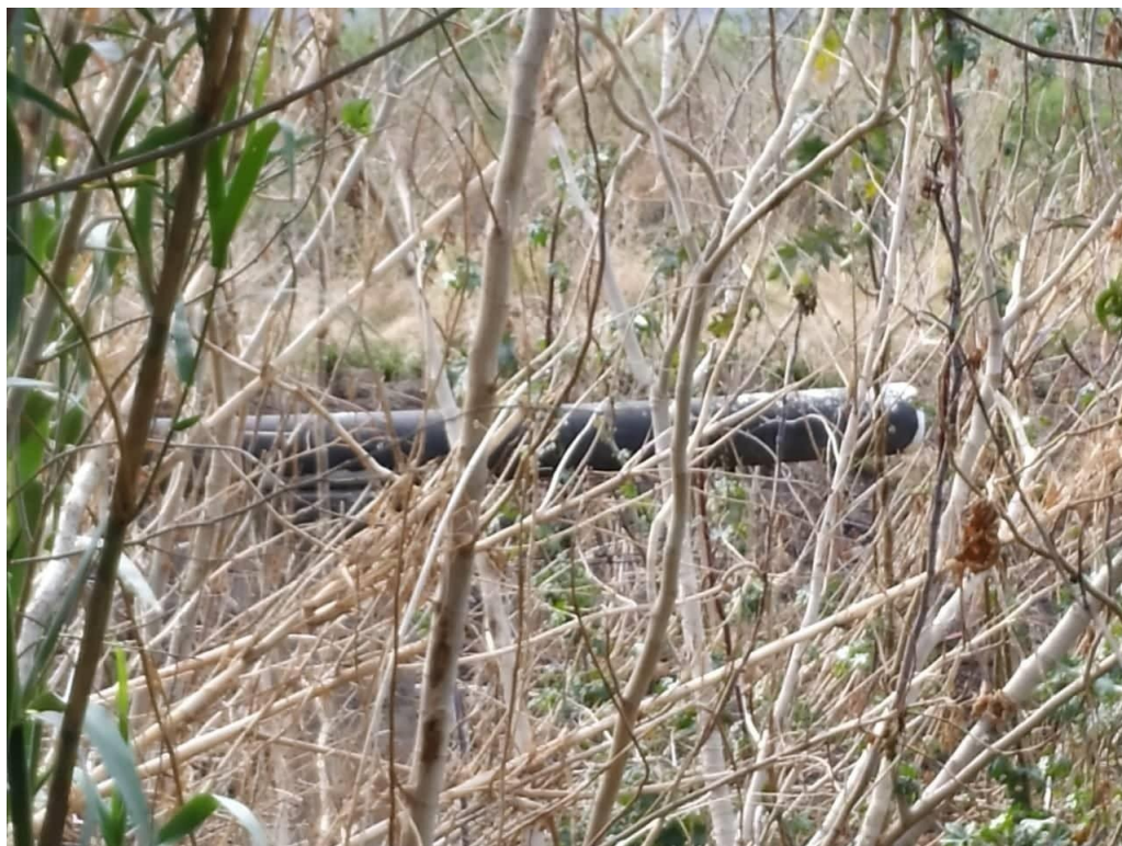
Imagen 130. Desague-piletones de deposición
