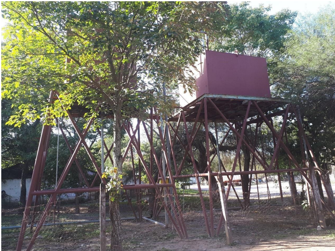
Imagen 108. Bomba y tanque de agua Lote El Puesto
