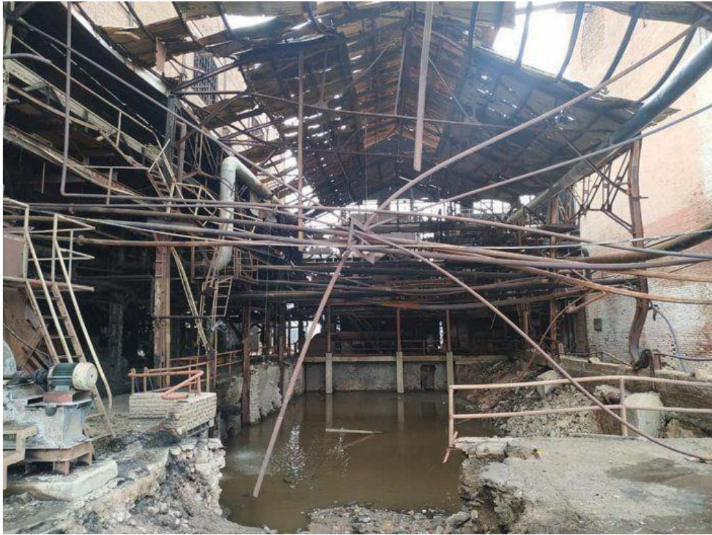
Imagen 138. Daños interior de la fábrica Ingenio La Esperanza
