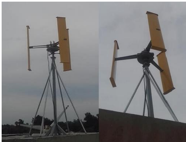
Figura 3: Aerogenerador instalado en la terraza del edificio de la Universidad.
