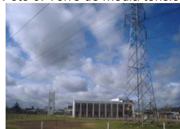
Foto 9. Torre de media tensión
