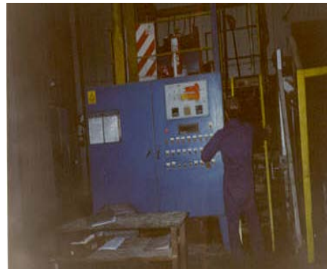
Foto nº - 26. Incineración de residuos patogénicos en las Instalaciones DESLER S.A
