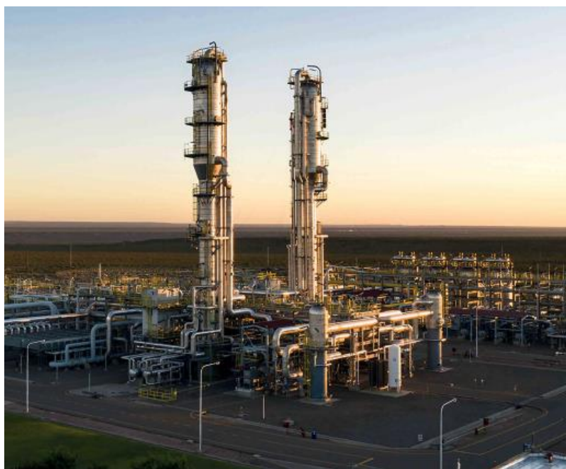
Planta separadora de la Compañía Mega. Loma La Lata. FUENTE: Compañía Mega S.A. (s/f).
