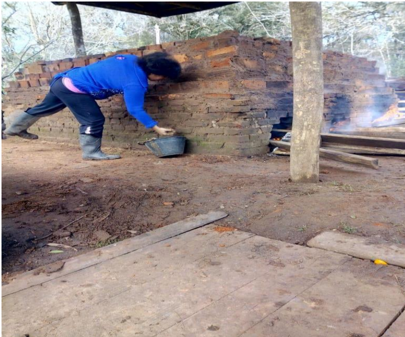
Foto 11: Paredes de contención del horno (Misiones)
