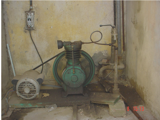
Foto 1. Bomba motor de una escuela primaria.
